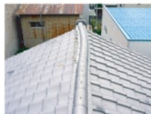
↑ 棟瓦が大きくズレてしまいました。
