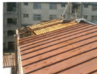
←板金屋根が強風のため吹飛んでしまいました。 (静岡市駿河区)
