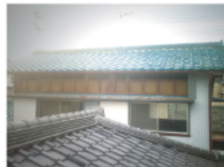
←トタン張りの壁面が飛ばされてしまいました。 (静岡市駿河区)
