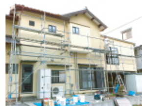
↑完成しました。外断熱により冬暖かく夏涼しい 住まいになりました。
